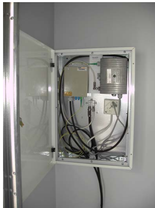
Подключенный волоконно-оптический кабель и распределительное оборудование заказчика в домашнем распределителе
