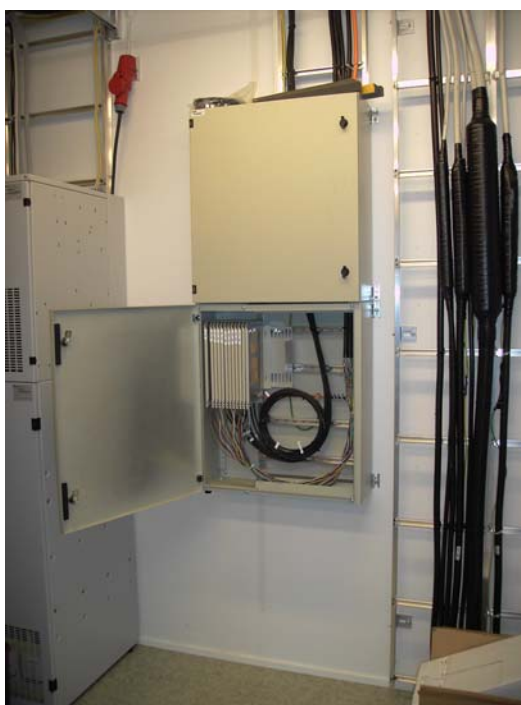
Шкаф для сварных соединений в технической комнате
